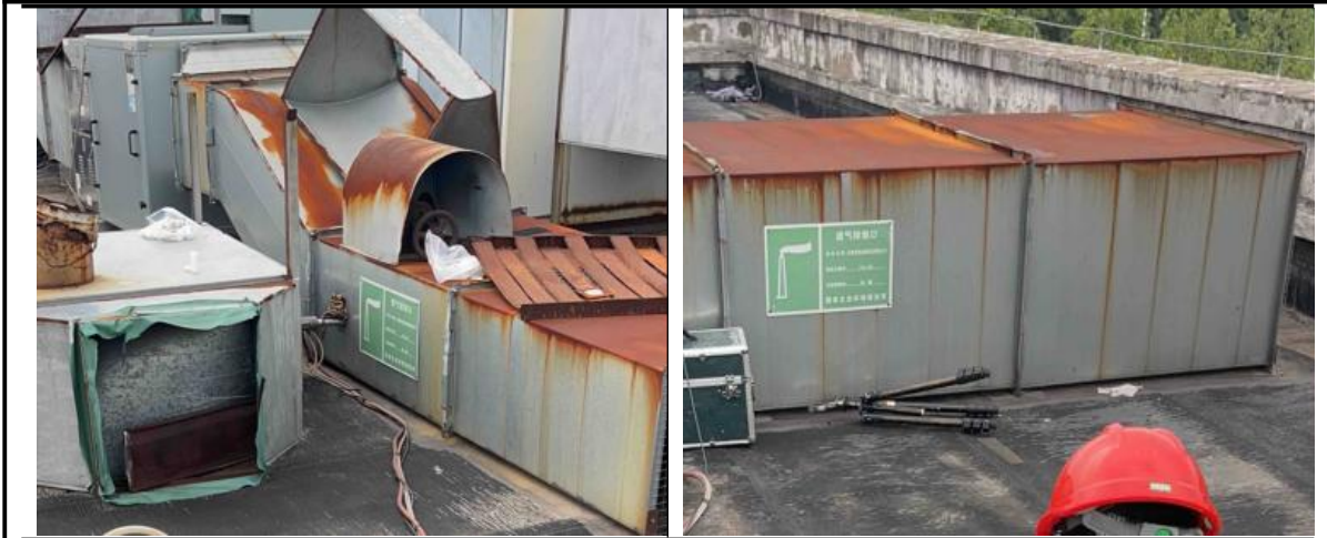
食堂油烟排气筒
