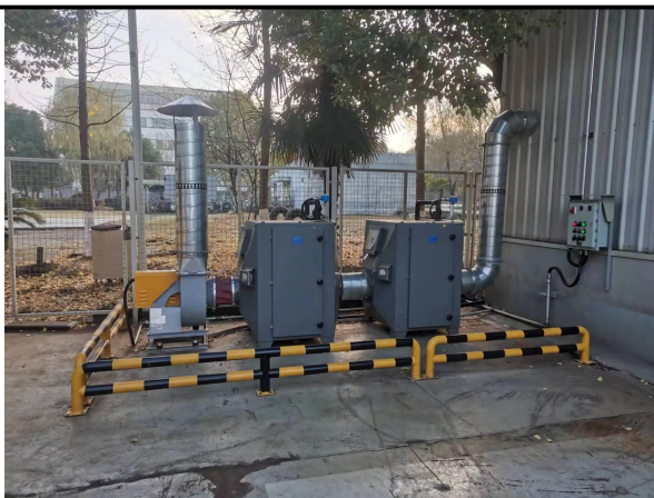
图 3-3 危废仓库活性炭过滤棉吸附装置
