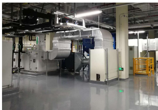
废气处理设施
