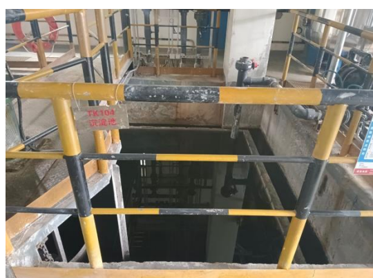
废水处理站池体
