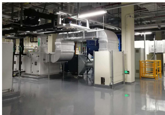
废气处理设施
