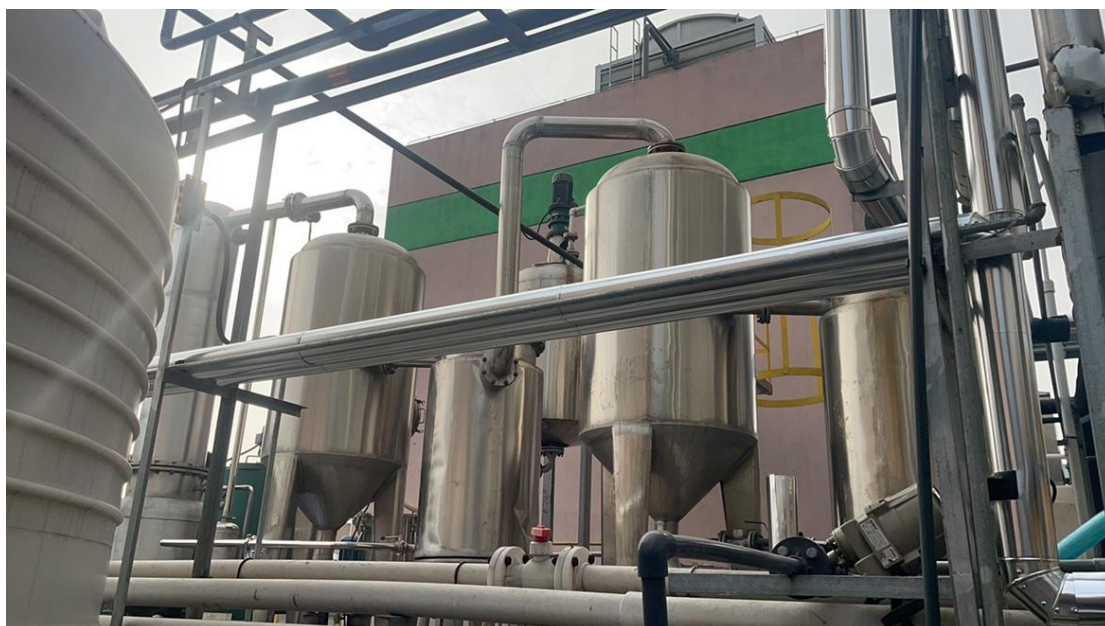
图 4-3 废水处理站照片
