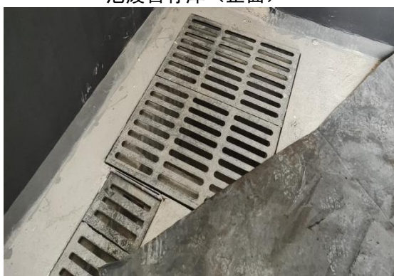
事故废液收集井
