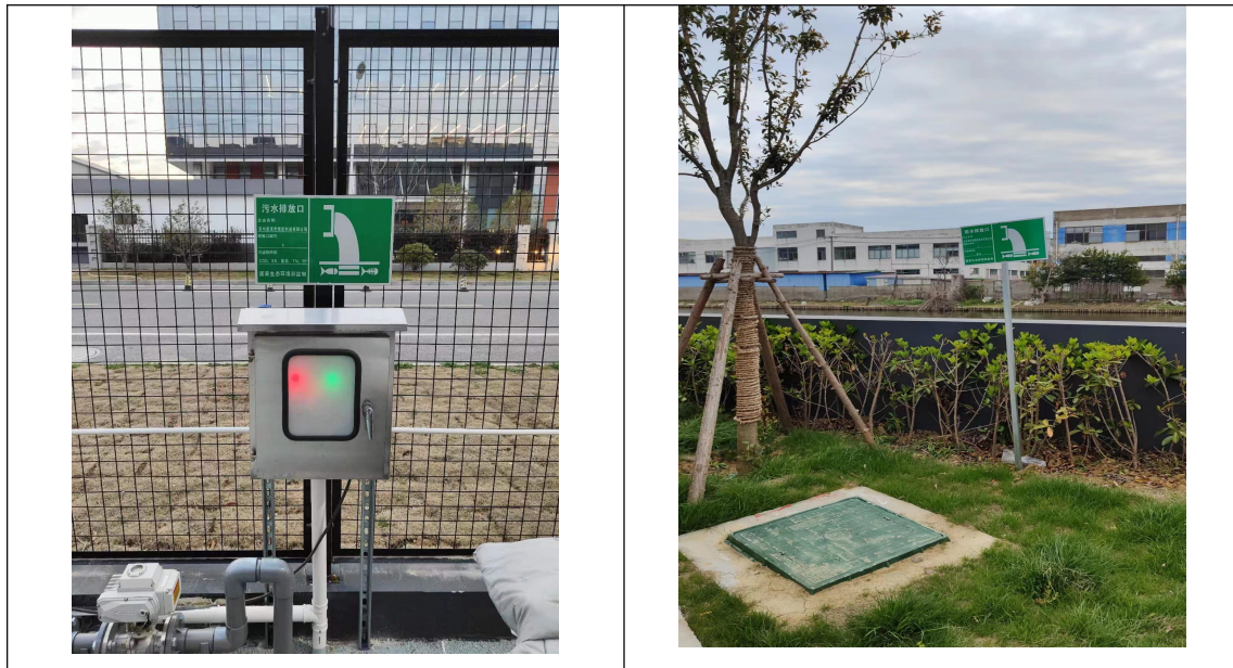
图 2.3.5-3 雨水、污水排放口及标识牌图片
