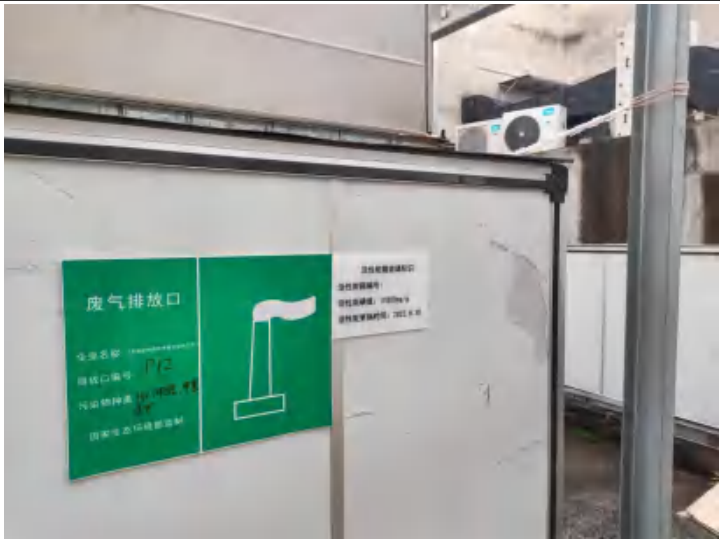
图 4-1 废气处理设施照片
