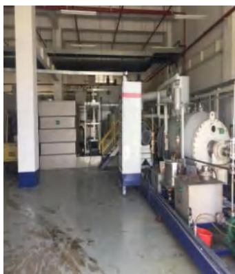
图 4-2 污水处理站照片
