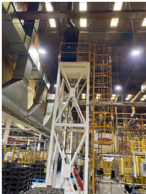
淬火油雾过滤器 1#
