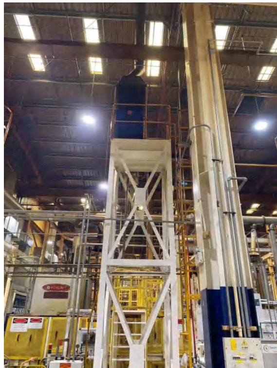
淬火油雾过滤器 2#
