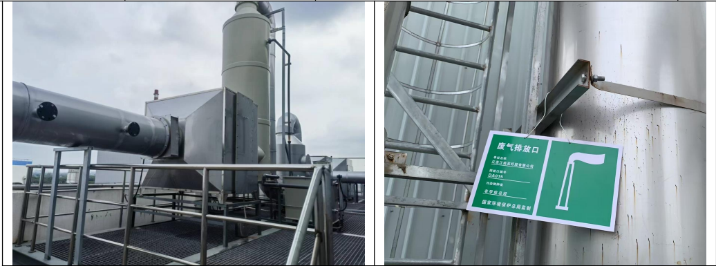
图 4-4 废气设施及标识牌
