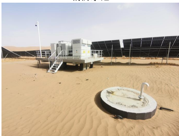
逆变一体机+事故油池
