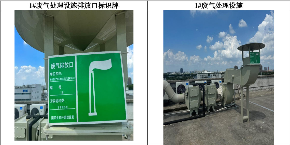
图 4-5 废气设施及标识牌
