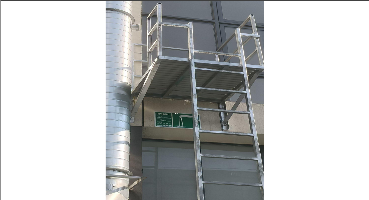
图 4-3 废气设施及标识牌
