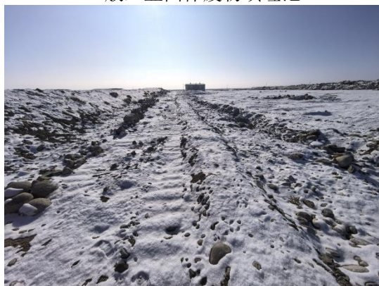
一般工业固体废物填埋池渗滤液导排系统
