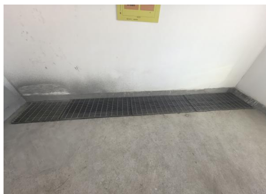
1#危废暂存间（导流槽）
