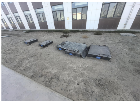
一体化生活污水处理设施
