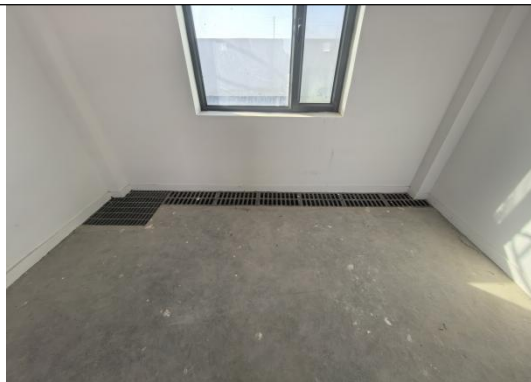
2#危废暂存间（导流槽）
