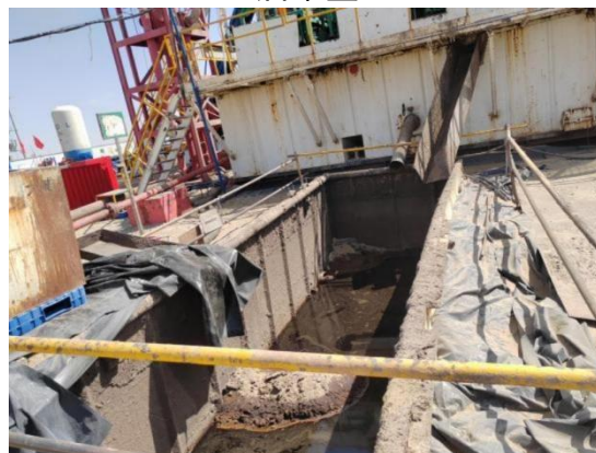
泥浆不落地设备
