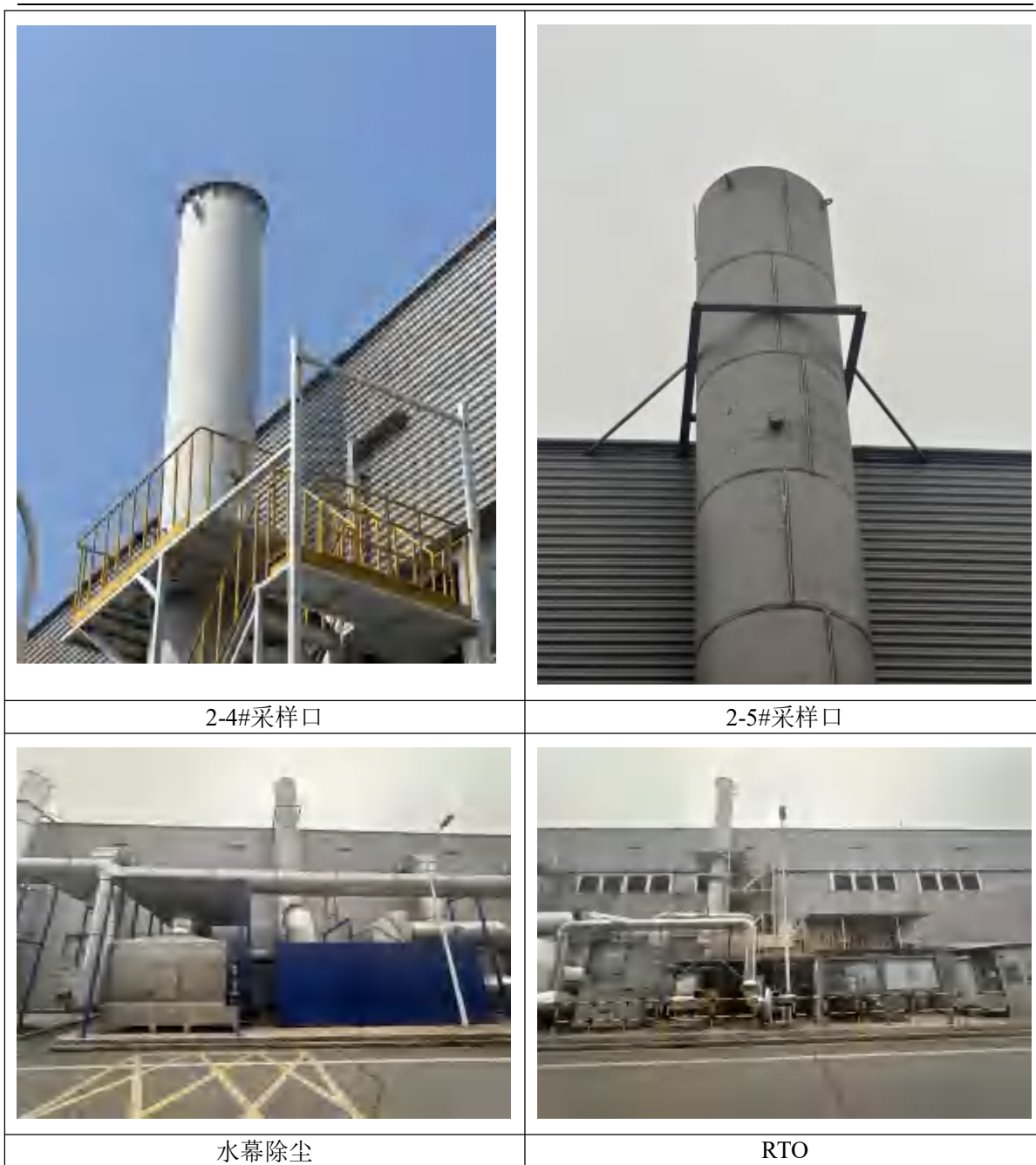
图 4-3 废气处理设施现场图
