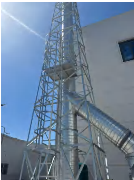
DA002 排气筒及采样口
