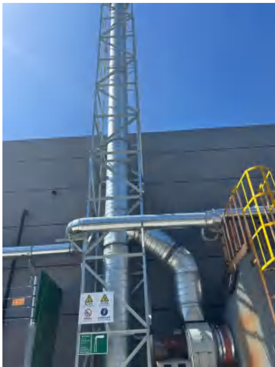
DA001 排气筒及采样口
